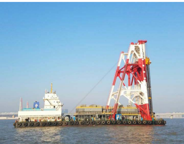
4 月 1 日,五公司砂桩 2 号前往香港机场第三跑道施工现场。该船已顺利通过香港机管局、环保局以及香港中国路桥 3204 标项目部的检验和审核,正式参与第三跑道扩建围海造地的软基处理工程施工建设。
